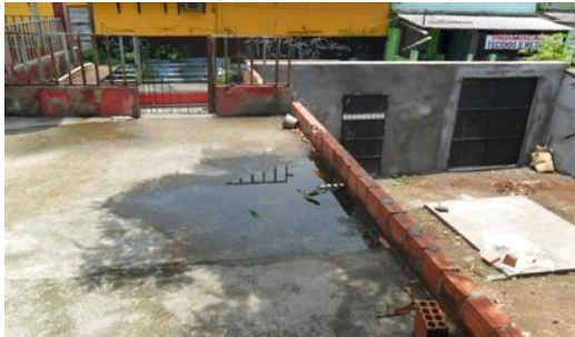
Figura 6: Acúmulo de água da chuva na laje da residência.
