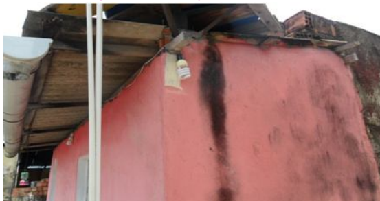
Figura 5: Escoamento da água da chuva no local indevido, desaguando na laje da residência.
