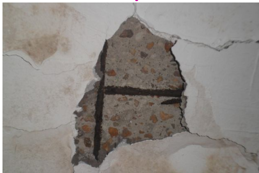
Figura 3: Descolamento do concreto da armadura de ferro da laje do banheiro e a oxidação da armadura.
