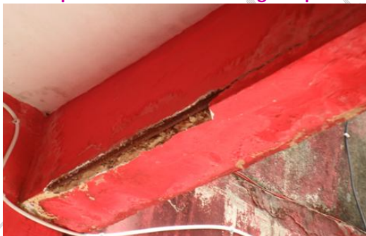
Figura 4: Armadura de ferro exposta e rachaduras na viga da porta de entrada da residência.
