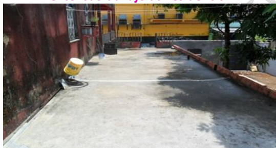
Figura 7: Acúmulo de água da chuva na lateral esquerda em toda a extensão da laje da residência.
