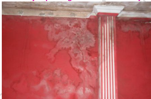
Figura 1: Parede lateral esquerda da entrada da residência. Manifestação patológica em estado avançado.
