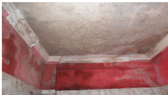
Figura 2: Manifestações patológicas evidentes dentro do banheiro da residencia.
