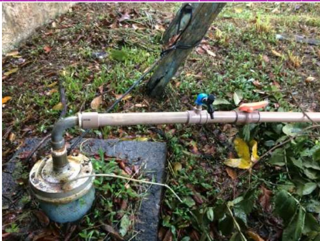
(a) Coleta número 1, local da Canalização reparada com inserção de torneira e registro para coleta de amostra de água do poço.
