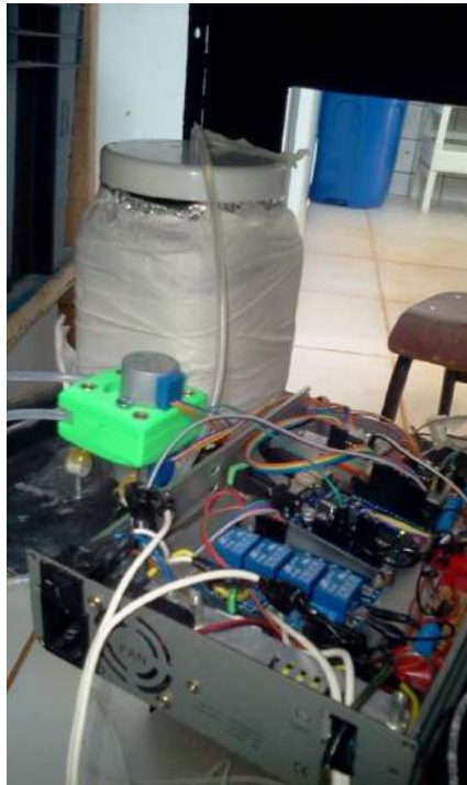
Figura 8 – Rack com o Sistema Eletrônico de Controle do Dosador de Hipoclorito.
