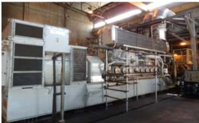
Figura 1 – MOTOGERADOR Wartsila Vasa 32 9R32LNGD
